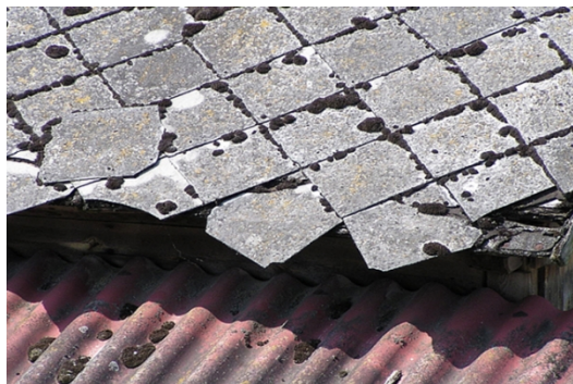
Rys. 8. Pokrycie dachowe ocenione w I stopniu pilności.
