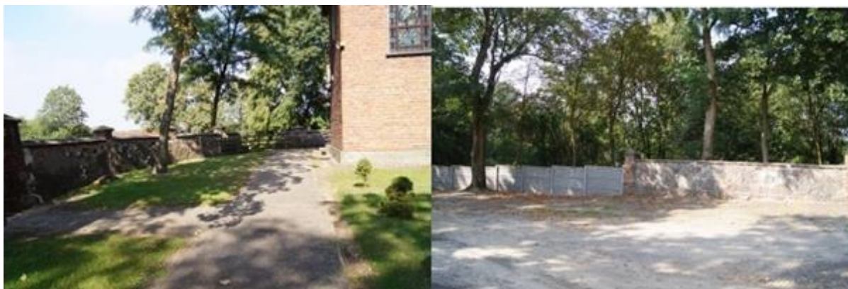
Ogrodzenie kościoła w Starych Skoszewach wymagające prac rewaloryzacyjnych i fragment nowego ogrodzenie z prefabrykatów betonowych kolidujących z zabytkową strukturą
