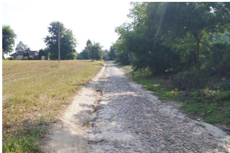
Budulec lokalny w nawierzchni drogi
